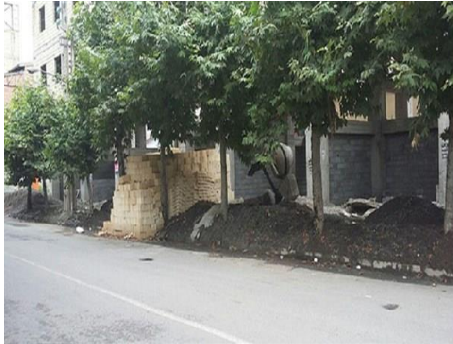
تخلیه نامناسب مصالح در پیاده رو
